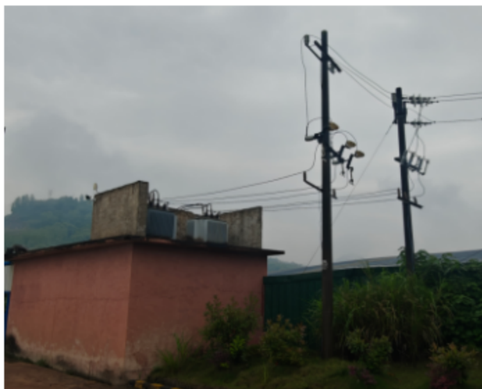
图 2.5-6 采场变配电设施
