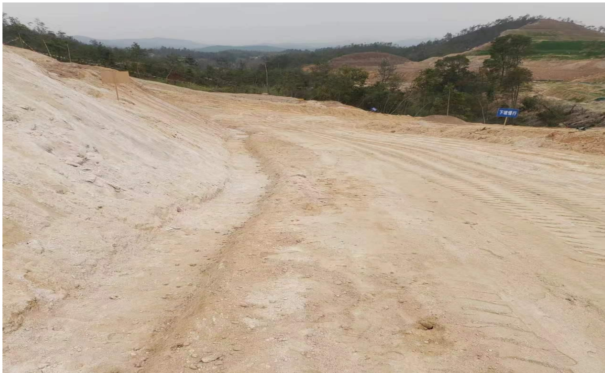
图2-5 上山公路排水沟
