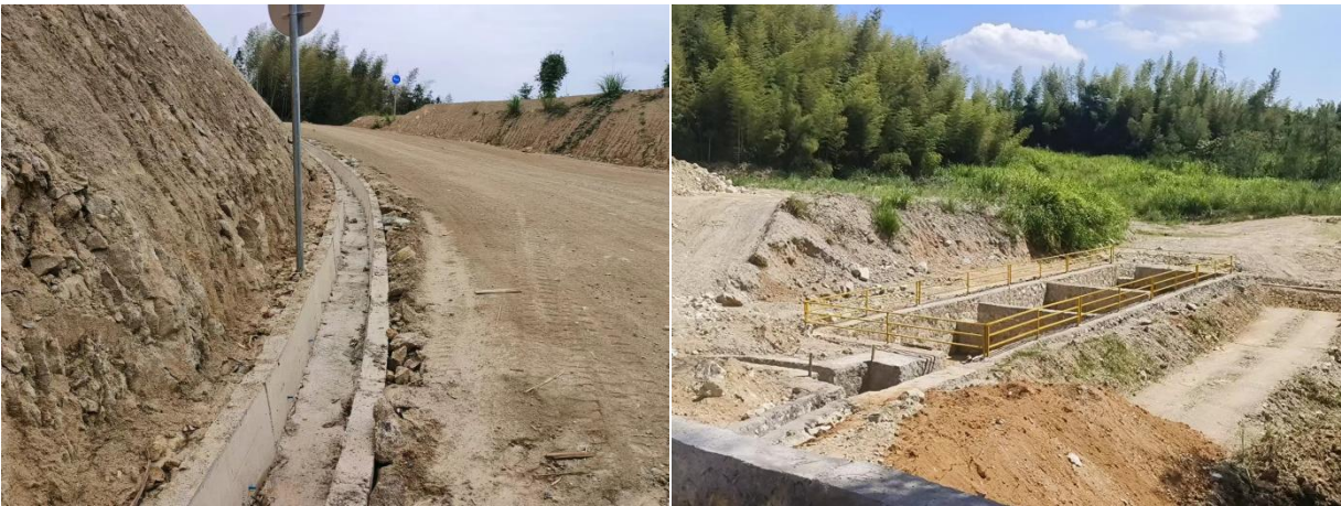
图 2.4-10 排土场截排水沟及沉淀池
