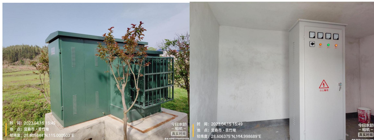
图 2.4-2 配电室及变压器
