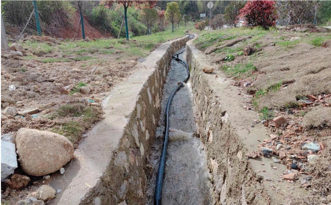
图 2.4-9 矿山道路内侧排水沟
