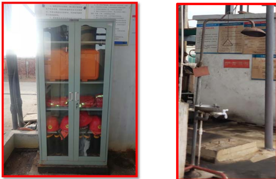
图 2.9.9-1 应急用品专柜、罐区洗眼喷淋器
