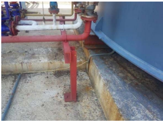
图 2.9.2-2 储罐接地装置、法兰盘间跨接
