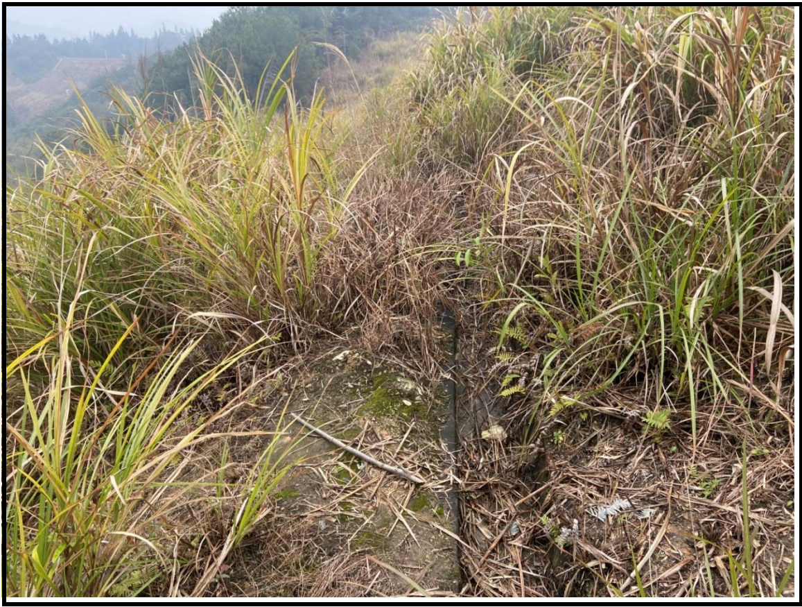
图 2-11 坝坡排水沟淤堵现状图
